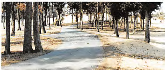
道路舗装を終了した北1番ホールと南1番ホール間の管理道
